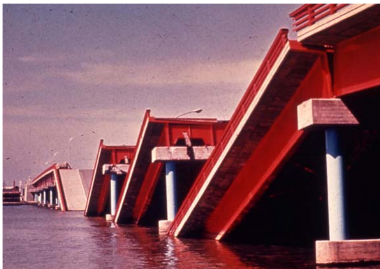
昭和大橋の落橋(1964年新潟地震)
