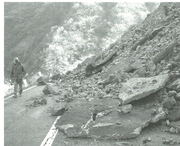
写真1 山古志村の道路寸断状況
