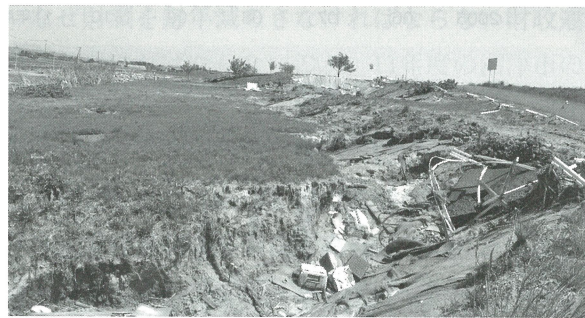
河川堤防の被害例（阿武隈川右岸）
