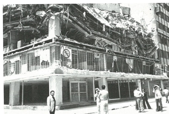
メキシコシティで発生した建物被害
