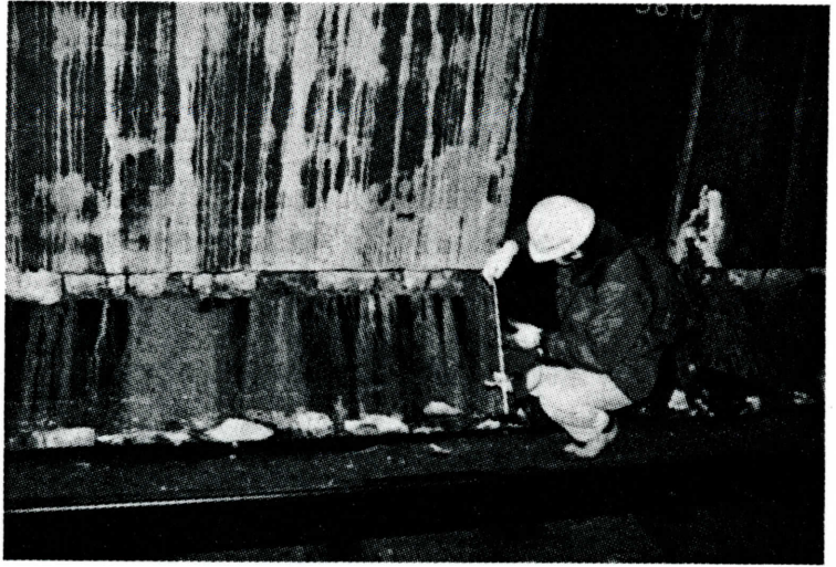
Photo.1 側壁下部の曲げによる水平クラック
