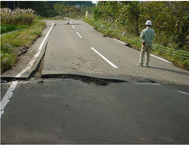
写真-3 段差の発生
