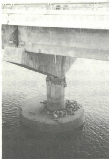
写真8 クワテス橋脚の圧壊
