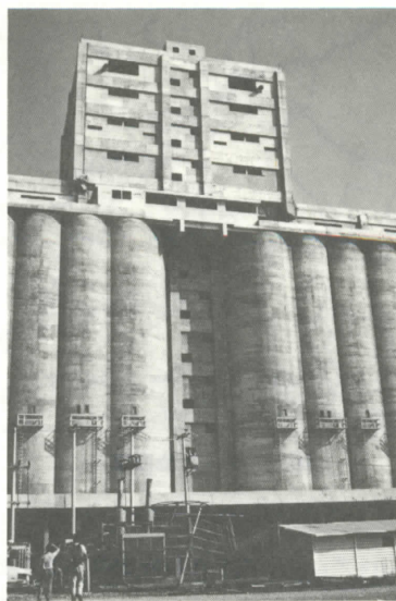
写真5 穀物サイロ上事務所の被害 (事務所2階が押し潰された)
