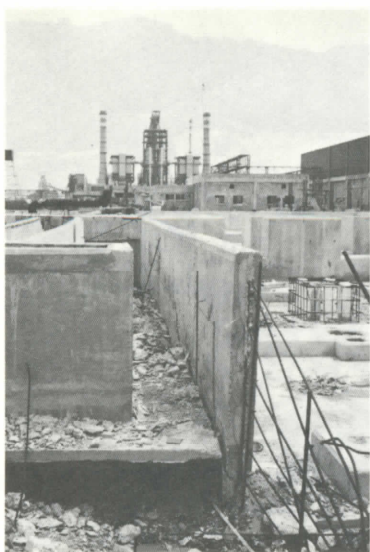
写真3 SICARTSA工業地区建設途上の日立造船屋土間コンクリートの不等沈下
