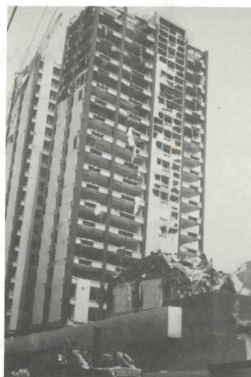
写真12 地下鉄Pino Suarez駅上の22階建鉄骨造ビルの倒壊 (倒壊したビルが隣りの14階建ビルを押し潰し、その1部が改札口で見られる)
