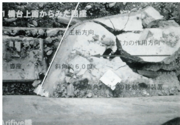
写真-4 A 2 橋台の桁移動制限装置の損傷
