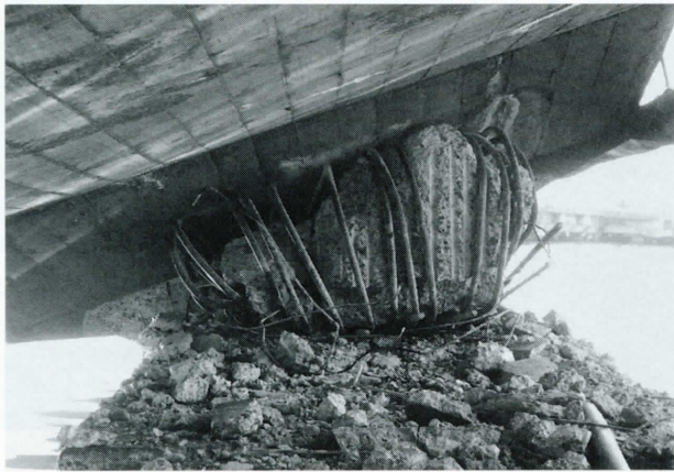
写真-17 橋脚のせん断破壊
