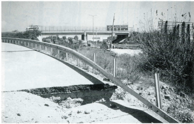
写真-8 No.1 橋梁（手前左から右橋台にかけ断層が走っている）
