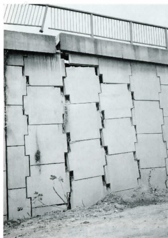
写真-5 A 1 橋台側部 テールアルメ の損傷
