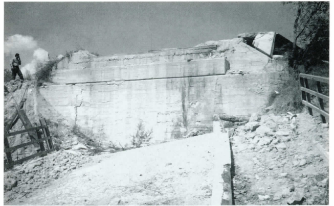
写真-14 No. 5 橋梁 A 1 橋台と落ちた桁
