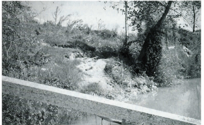
写真-15 左岸堤防下部を通過する地震断層
