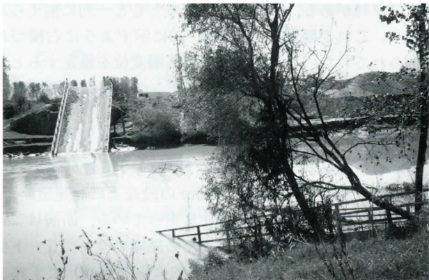
写真-13 No. 5 橋梁の落橋
