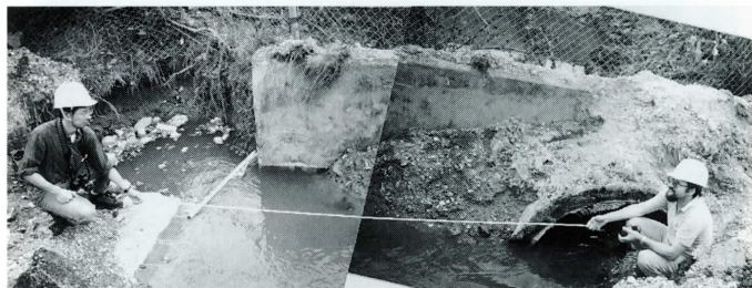
写真-7 断層による配水管のずれ
