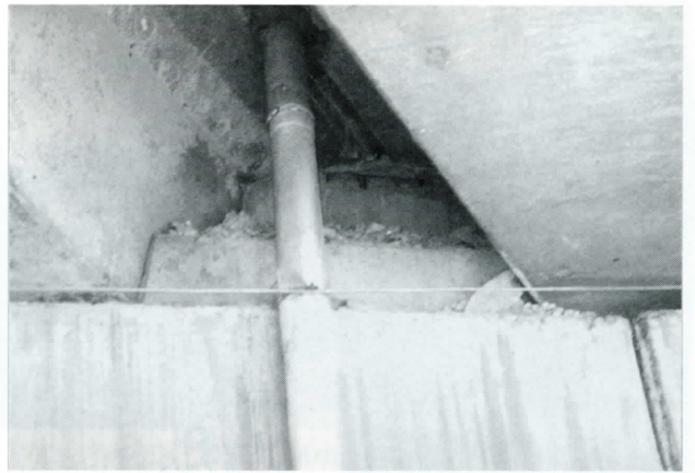
写真-10 No.2 橋梁の橋台支承部の損傷
